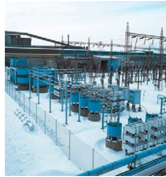
정지형 무효전력보상장치 (SVC)
